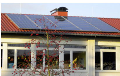
Photovoltaikanlage auf dem Dach der Grundschule Werther (M. Scheller)
