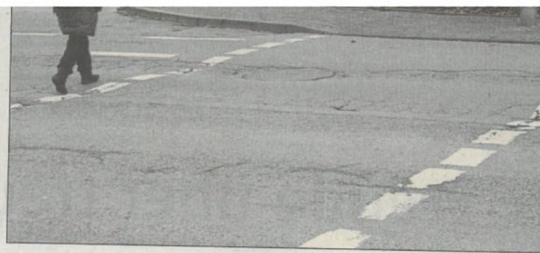
Tiefe Furchen in der Fahrbahn: Die Bielefelder Straße ist seit Jahren schadhaft, besonders an der ZOB-Kreuzung im Dorf.
