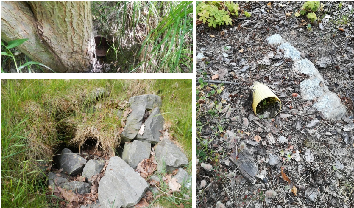
Abbildung 58, 59 & 60: Gehölzaufwuchs vor einem Rohrzulauf aufgrund jahrelang unterlassener Unterhaltung (oben links); kollabierter Zulaufbereich durch unzureichend befestigten Kolkchutz (unten links); Ablagerungen außerhalb und innerhalb eines Rohrzulaufs bei unzureichendem Gefälle im Kolkchutz bzw. Höhensprung hinter dem Rohr bei mangelhafter Unterhaltung (rechts)
