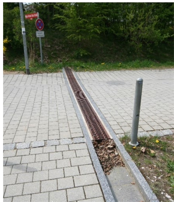
Abbildung 23: Blockierter Fließquerschnitt durch Ablagerungen vor einer Kastenrinne
