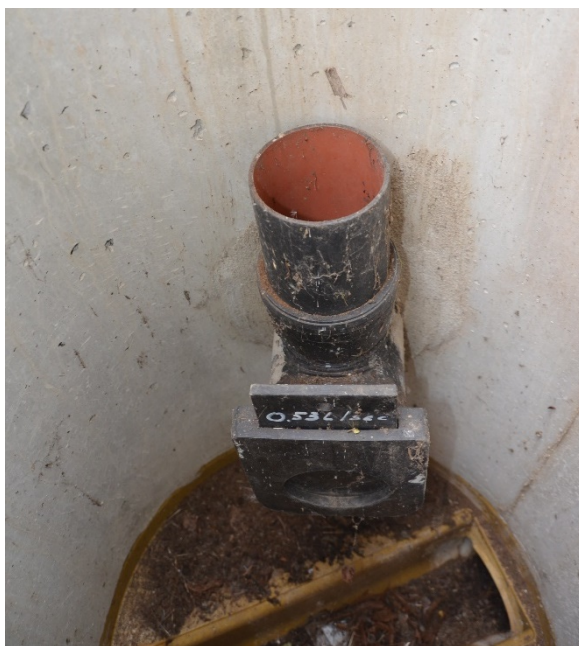
Abbildung 78: Lochblendendrossel mit intensivem Eintrag von Laubresten im Schachtboden. Bei kleinen Durchmessern ist regelmäßige Prüfung der Ablaufleistung unbedingt notwendig
