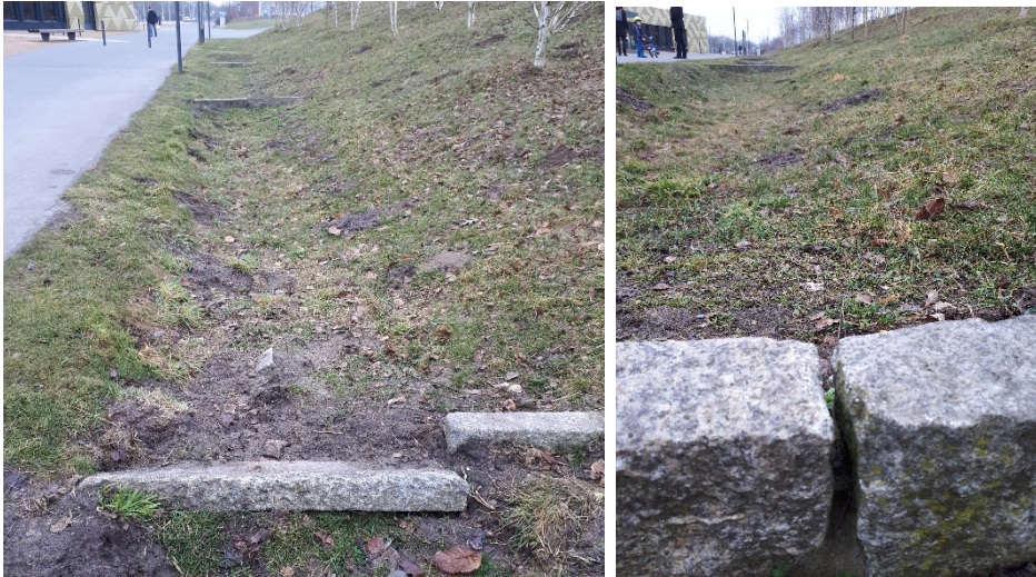
Abbildungen 71 & 72: Unplanmäßiger Überlauf durch beschädigte Kaskadensteine (links) und Ausspülung der Fugen (rechts).
