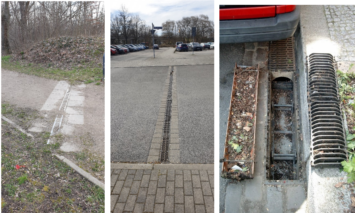
Abbildung 45a-c: Hohe Anfälligkeit von Kastenrinnen gegenüber Zusetzen bei Einsatz in wassergebundenen Wegedecken (links) und geringe Anfälligkeit bei Asphaltdecken (mitte); Beispiel für regelmäßig auftretende Sedimentablagerungen, die im Rahmen der Wartung entfernt werden müssen (rechts)
