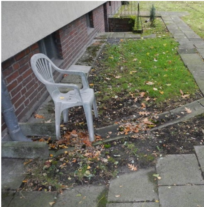
• Abbildung 17: Fehlerhafter Rinnenanschluss aufgrund von Gefälleverlust und Laubeintrag. Sedimentablagerung und Ausspülungen in der Grünfläche als Zeichen für wild abfließendes Wasser erkennbar.
