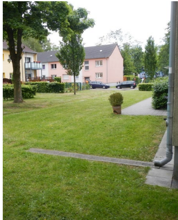
Abbildung 20: Positives Beispiel für offene Rinne mit regelmäßiger Pflege und Kontrolle des durchgehenden Gefälles
