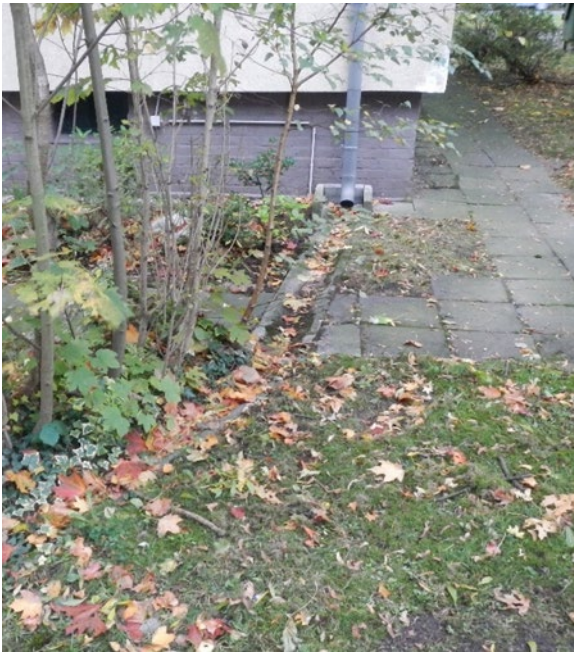
Abbildung 21: Sedimentablagerungen und Laubeintrag in offener Rinne zur Wegequerung
