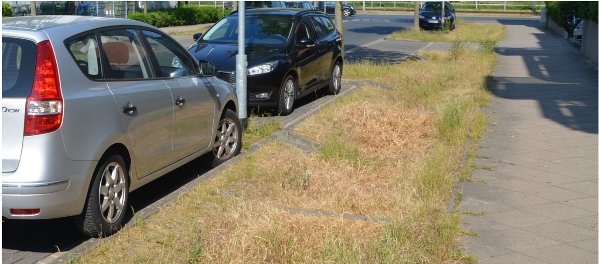
Abbildung 69: Kaskadenwall in Betonbauweise in straßenbegleitender Mulde, der auch zur Querung der Mulde genutzt wird. Keine typischen Erosionsspuren von informellen Laufwegen.
