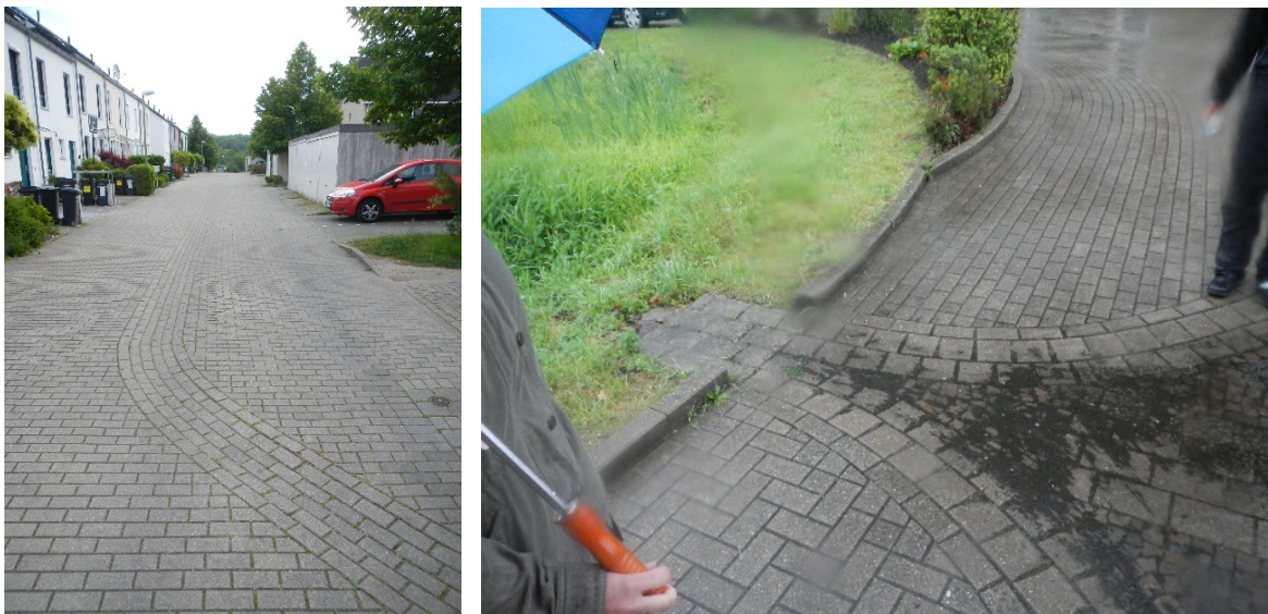
Abbildungen 39 & 40: Ableitungsrinne im V-Profil mit moderaten Kurvenradien (links) und Rinne im Straßenraum mit Sedimentablagerungen aufgrund beruhigter Strömungsbereiche (rechts)
