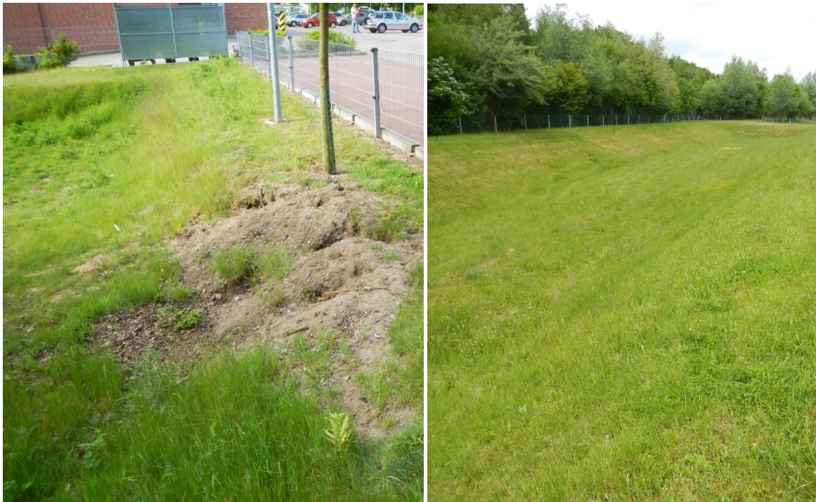
Abbildungen 65 & 66: Erosion der Muldenböschung durch Wühltiere in Verbindung mit einer für sandige Böden zu steilen Böschungsneigung (links); Böschung mit moderater Neigung und ordnungsgemäßigem Pflegezustand (rechts)
