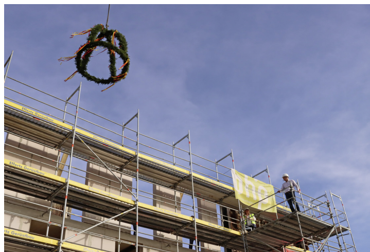
Die Richtkronen über dem Neubau des Kreishauses an der Straße „Auf dem Stempel“ in Gütersloh.
